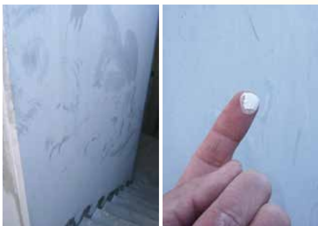
前面に広がった白華の様子。指でなぞると白粉(炭酸カルシウムの結晶)が付きまします。この状態は仕上げ材との付着を阻害する危険性があります。
